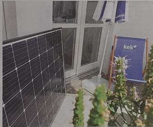
Die Sonnenenergie nutzen: Mit Solarmodulen auf dem Balkon kann auf einfache Weise Strom erzeugt werden. Foto: KEK/Karlsruher Energie- und Klimaschutzagentur
